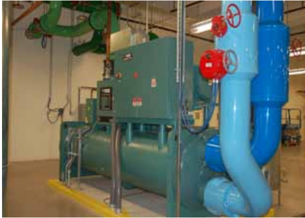
550 Ton York Chiller
